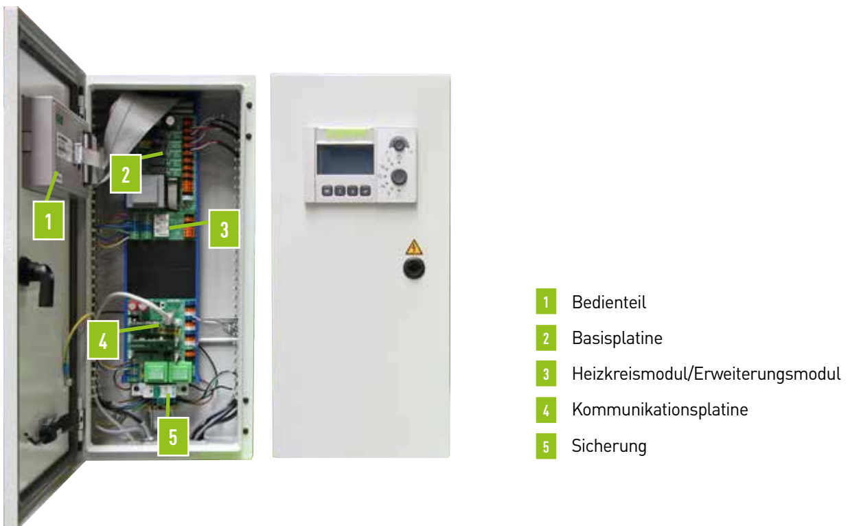
Abb. 23: Schaltschrank für die Übergabetechnik
